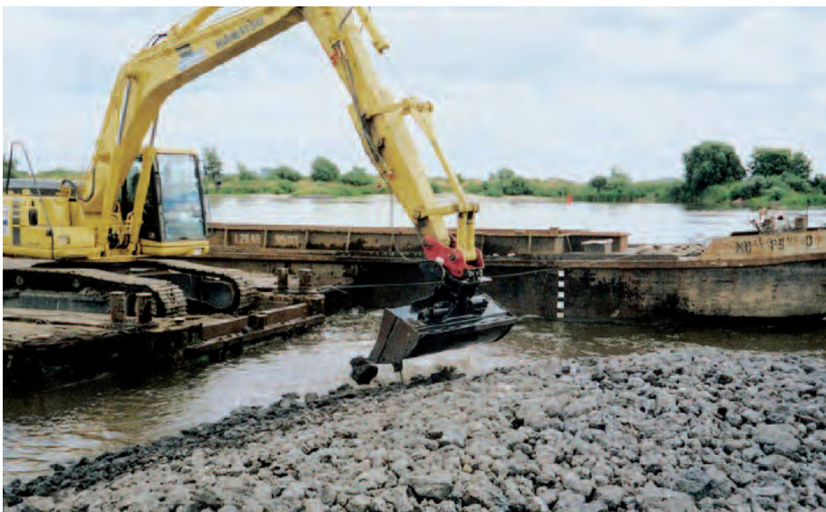
Bild 1 | Uferbefestigungen aus Schlacke, wie hier an der Elbe, sind auch im Wasserbau ein wichtiges Element.
